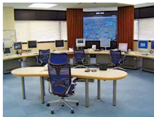
北茂安浄水場 中央操作室
